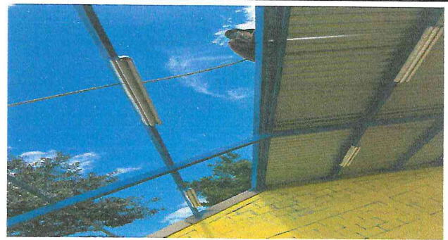
Foto 4: Aulas y baños sin laminas
